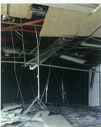
以前のRDVシステムズの社屋。2階の全面ガラスが完全に割れ、室内は天井崩れ落ち、床もめくれ上がるという惨状だった。目の前にある山が揺れたのだと言う。
